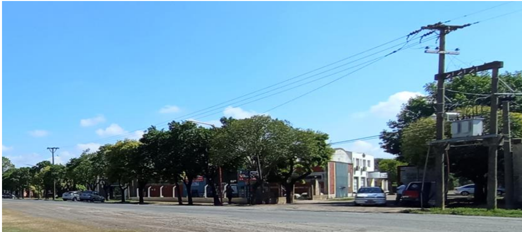
Figura 19 - Transformador de media tensión (Fuente: Elaboración propia)
