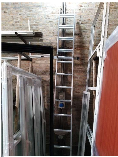
Fig. 49. Toma corriente obstruido x una escalera.
