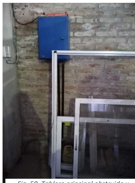
Fig. 50. Tablero principal obstruido x trabajos en WIP
