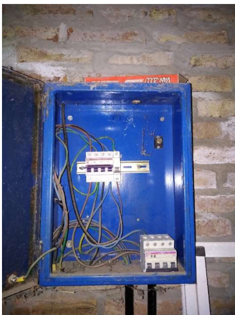
Fig.45. Tablero eléctrico principal
