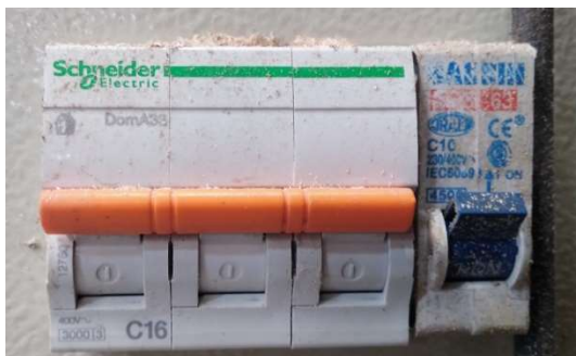
Fig. 77. Toma corriente con protección térmica tripolar no permitida
