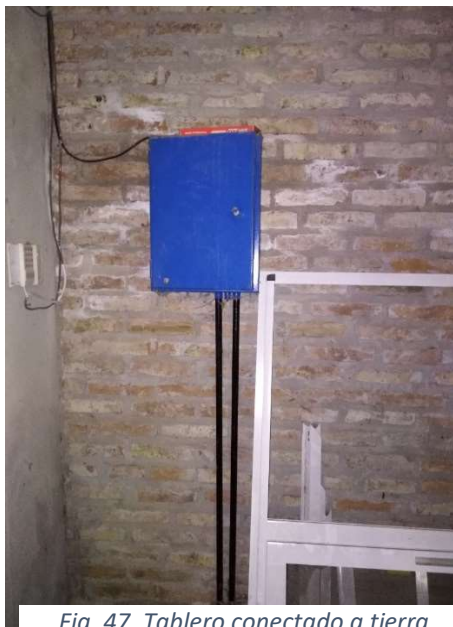
Fig. 47. Tablero conectado a tierra
