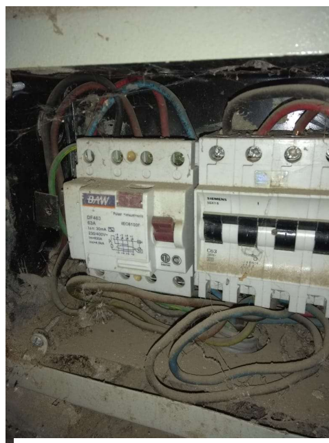
Fig. 46. Tablero secundario con disyuntor diferencial.
