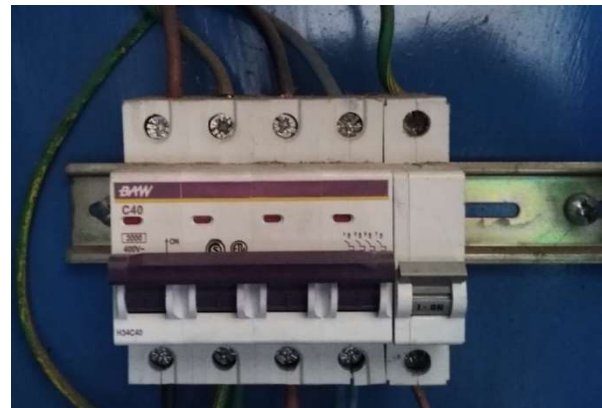
Fig. 73 a. Interruptor termomagnético + llave unipolar
