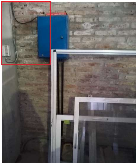
Fig. 81. Conductores colgando sin contención
