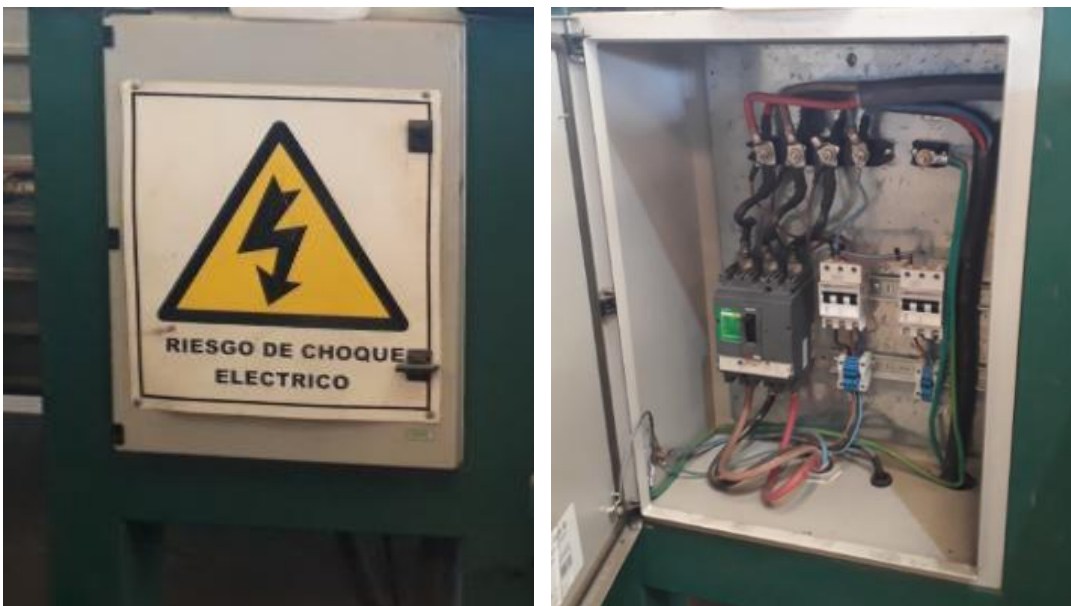
Imágenes 25 y 26: Interior y exterior de tablero eléctrico Sector: corte de materias primas
