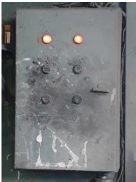
Imagen 29: Tablero eléctrico Sector: pintura de partes
