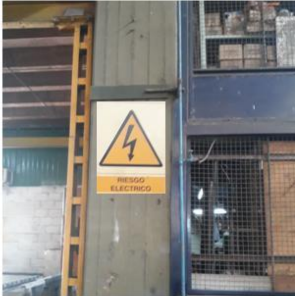
Imagen 68: Cartel de riesgo eléctrico Sector: Pintura de partes
