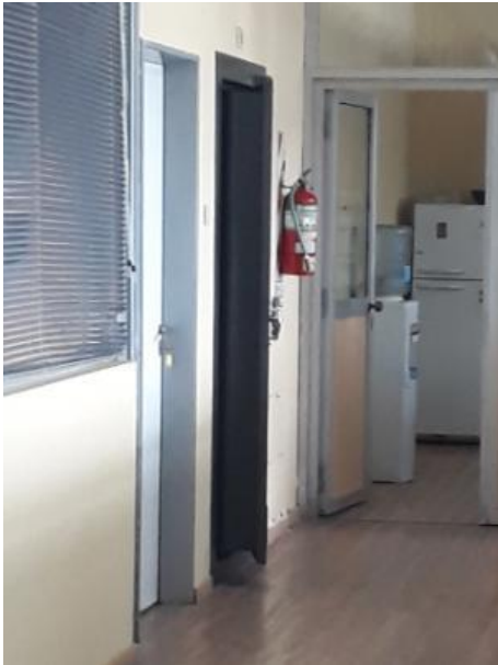
Imagen 39: Extintor ABC de 5kg en sector administrativo
