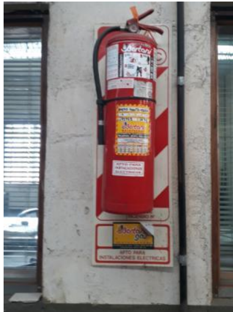
Imagen 40: Extintor ABC DE 10 kg en pared exterior de la oficina técnica
