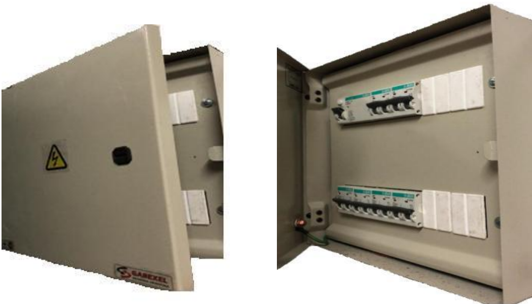
Imágenes 37 y 38: Interior y exterior de tablero secundario 2
