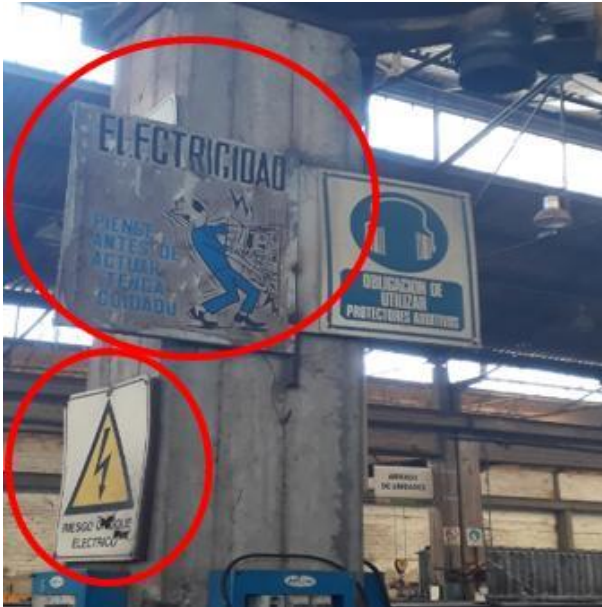
Imagen 70: Carteles de riesgo eléctrico en mal estado. Sector: Armado de partes
