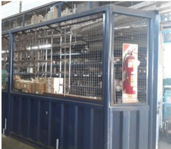
Imagen 65: Extintor colocado Sector: pañol de herramientas
