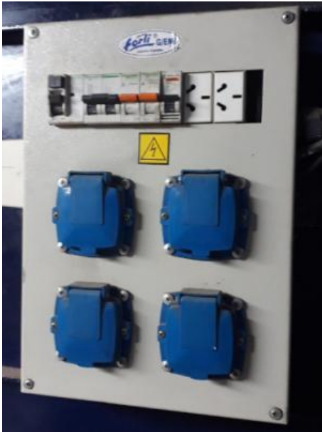
Imagen 30: Toma corriente Sector: armado de partes
