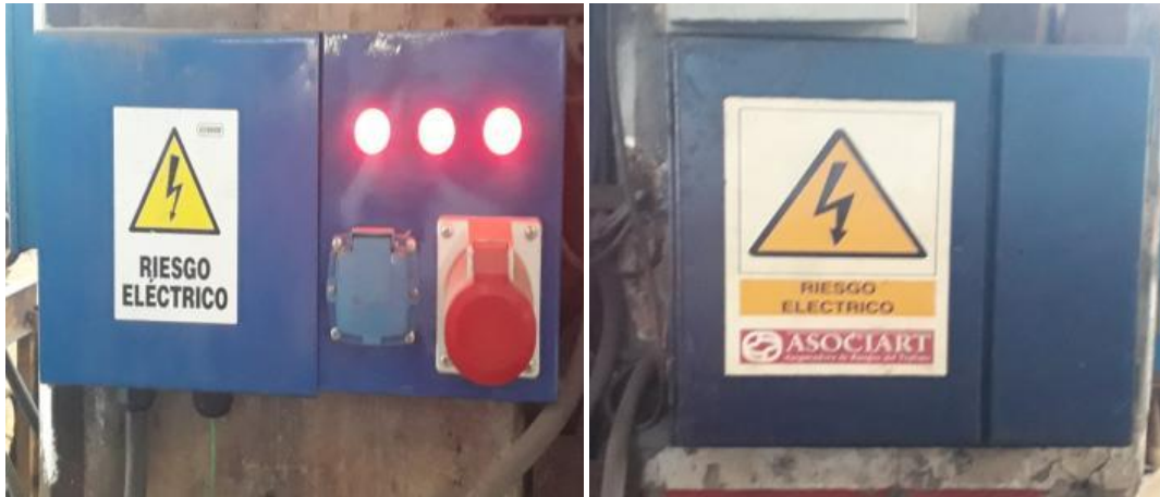
Imagen 66 y 67: Cajas de interruptores eléctricos y tomas
