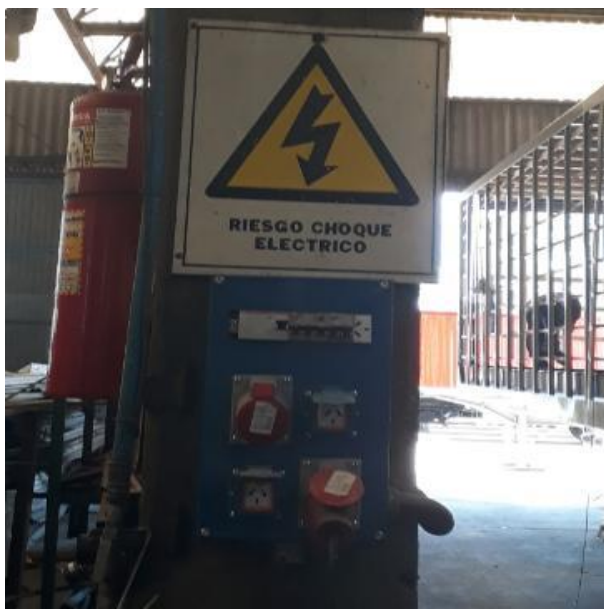
Imagen 69: Cartel de riesgo eléctrico Sector: Plegado de la materia prima
