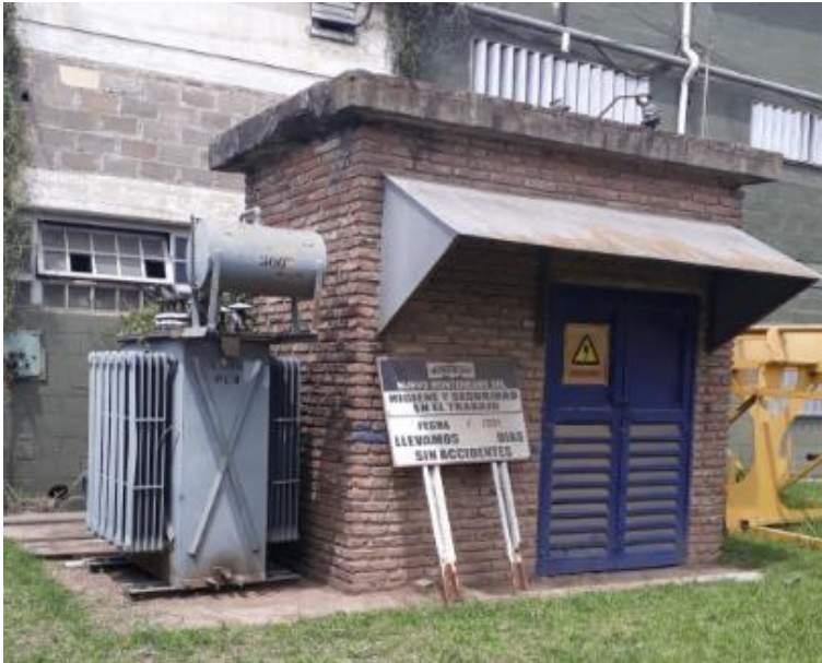
Imagen 24: Subestación de energía eléctrica
