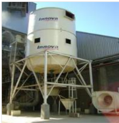
Figura 17. Aspiración lateral en descarga de camiones
