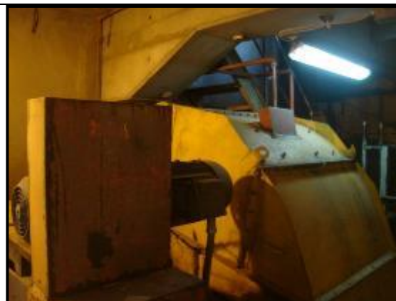
Figura 33. Falta tapa de alivio de presión.
