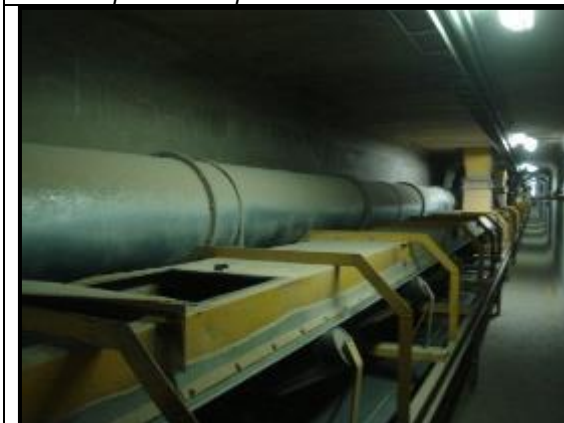
Figura 28. Conducto de aspiración con tapa de inspección abierta.
