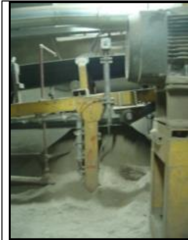
Figura 24. Túnel cinta. Acumulación de polvo en el piso.
