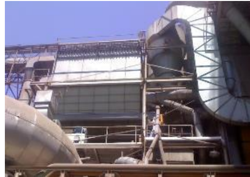
Figura 16. Sistema de aspiración en descarga
