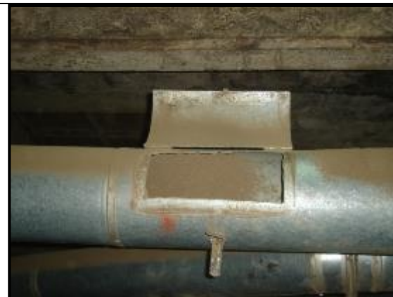
Figura 29. Conducto de aspiración con tapa abierta.
