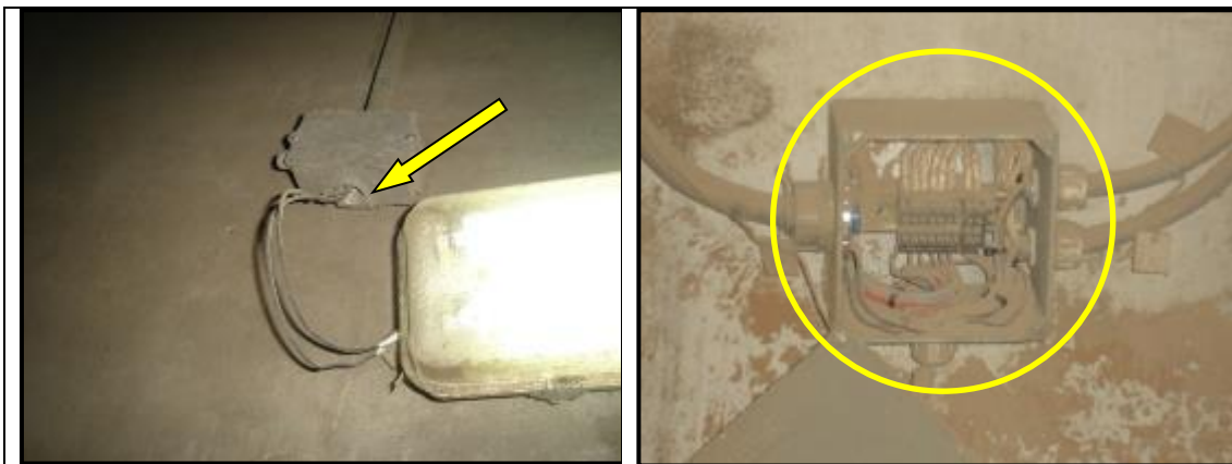
Figura 36. Caja eléctrica con prensacable faltante.
