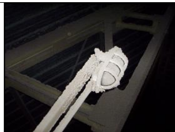
Figura 45. Artefacto de iluminación no adecuado a normas.
