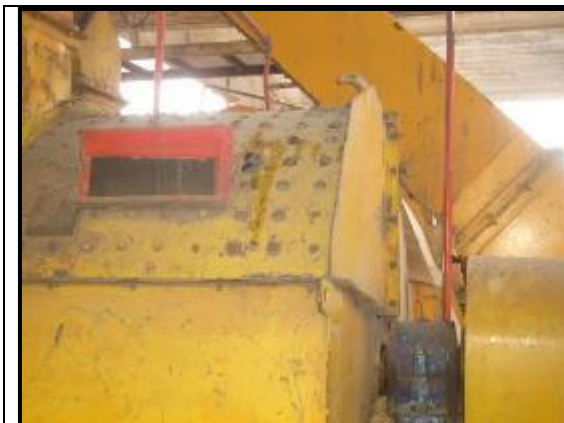
Figura 32. Falta tapa de alivio de presión.
