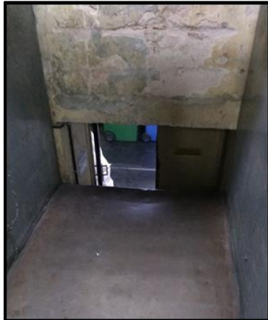
En el sector, se cuentan con distintos equipos de extracción instalados. Foto 2.
