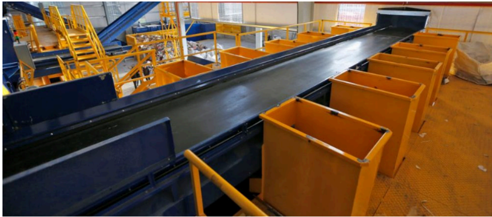
Figura A.2.9. Estructura elevada con cinta de clasificación DEISA CP14080. Fuente: DEISA.
