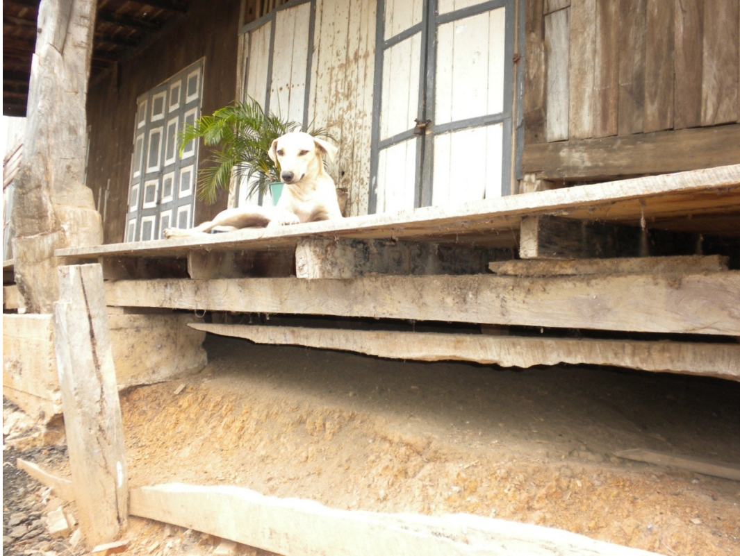
Ilustración 5: Detalle de estructura de piso de planta baja. Hacienda La Cuba, Vinces Ecuador
