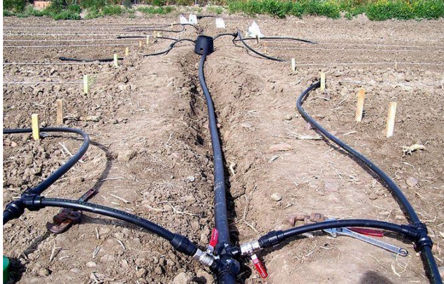
Sistema de riego por goteo con cañerías de polietileno de baja densidad
