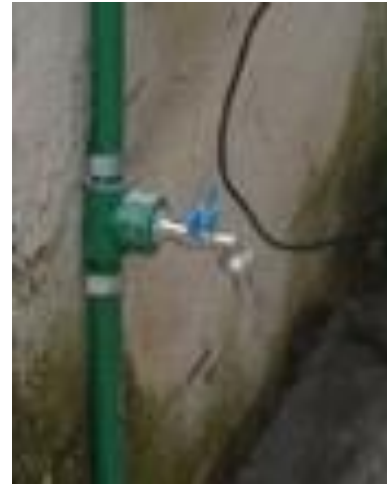
Ubicación de canilla de servicio en montante
