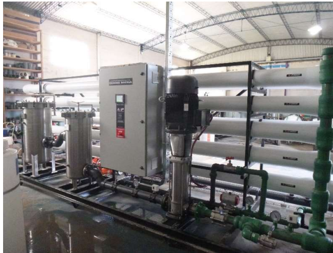
Imagen 16 – Interior en una nueva planta de ósmosis en El Trébol. Año 2014.
