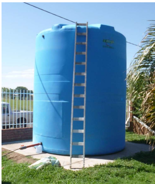
Imagen 15 – Cisterna de agua cruda (de polietileno) en la planta de Villada. Año 2014.
