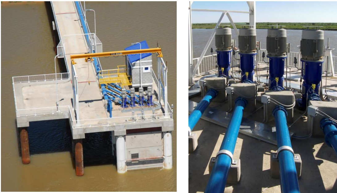
Imágenes 11.1 y 11.2 - Obra de toma en Monje, vista general y bombas. Acueducto Centro Oeste.
