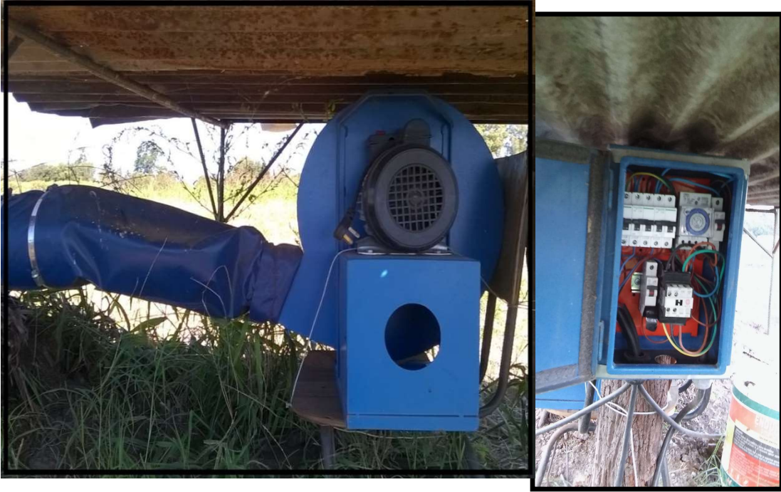
Foto 8 y 9: Aireador e instalación eléctrica del sistema de compostaje con aireación forzada
