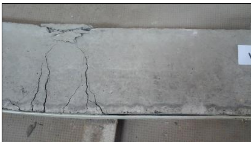
Figura 4.3 - Detalle zona de rotura V5 (2db12).
