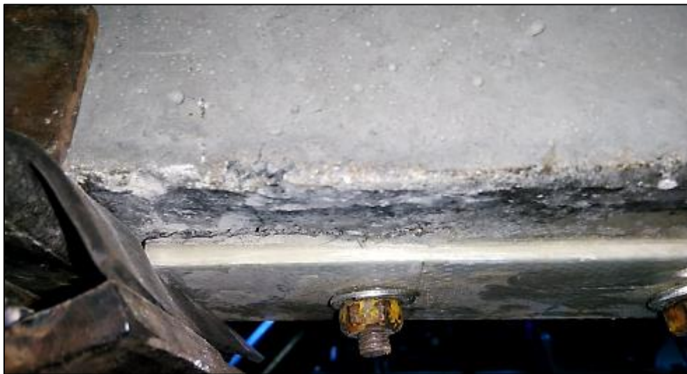
Figura 4.23 - Lámina desprendida en la viga V1.3
