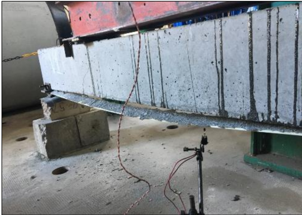
Figura 4.24 - Desprendimiento completo de la lámina y corte de los bulones en un extremo de la viga V1.
