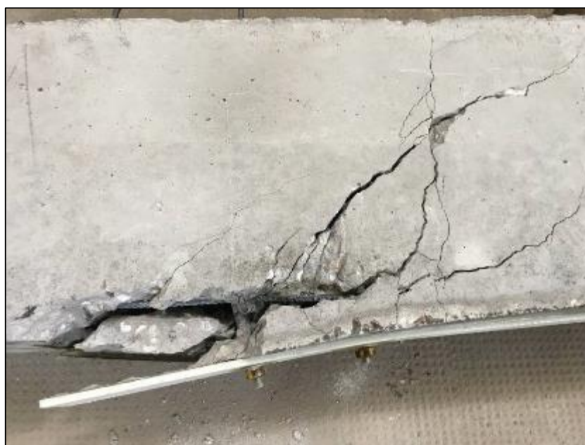
Figura 4.10 - Detalle desprendimiento de recubrimiento en V11 (2db8).
