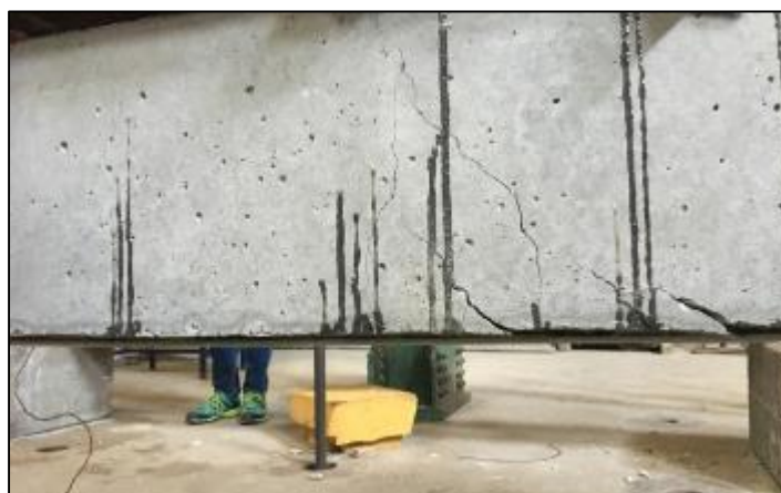
Figura 4.21 - Fisuras de la viga debido a la flexión, debajo de la carga aplicada V1.
