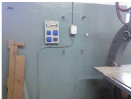
Figura 39: Vista instalaciones eléctricas taller carpintería Fuente:Elaboración Propia
