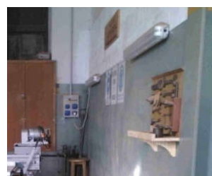
Figura 53: Luz de emergencia taller de carpintería
