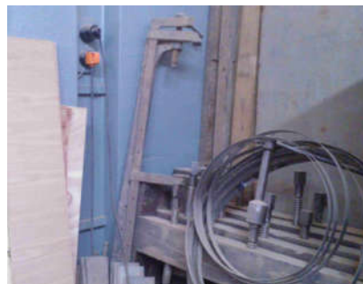
Figura 40: Vista instalaciones eléctricas taller carpintería Fuente:Elaboración Propia
