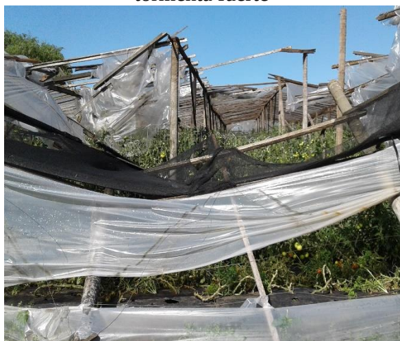
Foto 17. Invernáculos rotos luego de una tormenta fuerte
